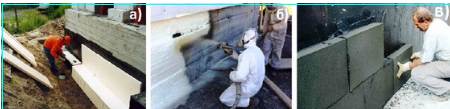
Утепления конструкций фундамента снаружи плитами экструзионного пенополистирола (а), напыляемым пенополиуретаном (б) и блоками из пеностекла (в)
