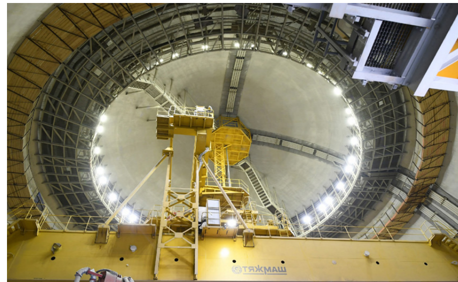
Курская АЭС. Мостовой кран под куполом реакторного отделения
